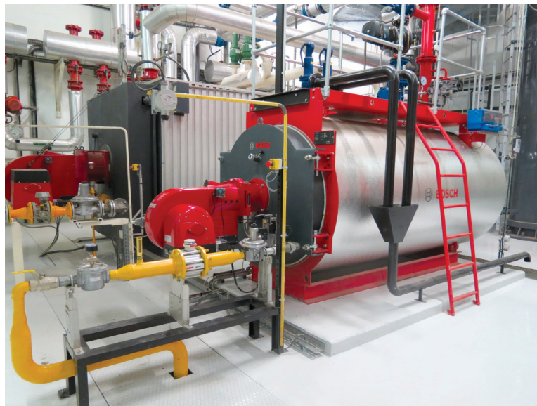
La chaudière biomasse de l'usine d'Onet-le-Château couvre 90% des besoins du site.
